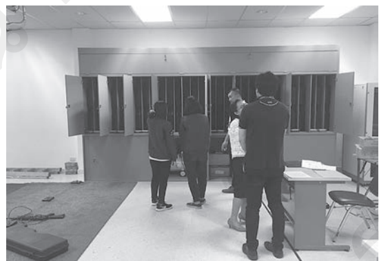
รูปที่ ๑๒ แสดงงานติดตั้งตู้เก็บเครื่องมือต่างๆ
