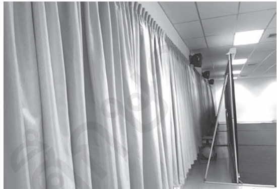
รูปที่ ๑๐ แสดงงานติดตั้งอุปกรณ์ควบคุมแสง จากภายนอก(ผ้าม่าน)
