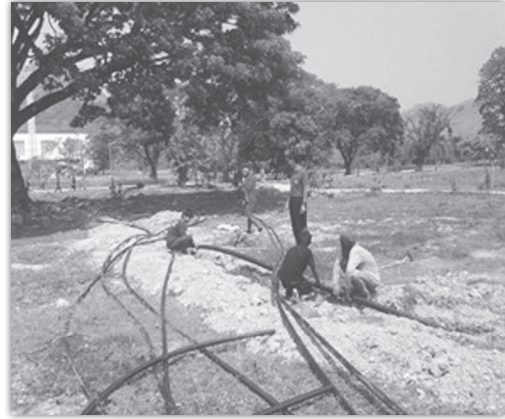
ภาพที่ ๑๓ การเดินระบบท่อส่งน้ำสปริงเกอร์
